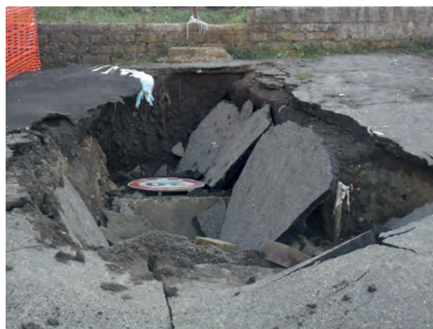
Fig. 24 – Voragine a Prima Porta, 21 ottobre 2011. – Anthropogenic sinkhole at Prima Porta district, 21th October 2011.
