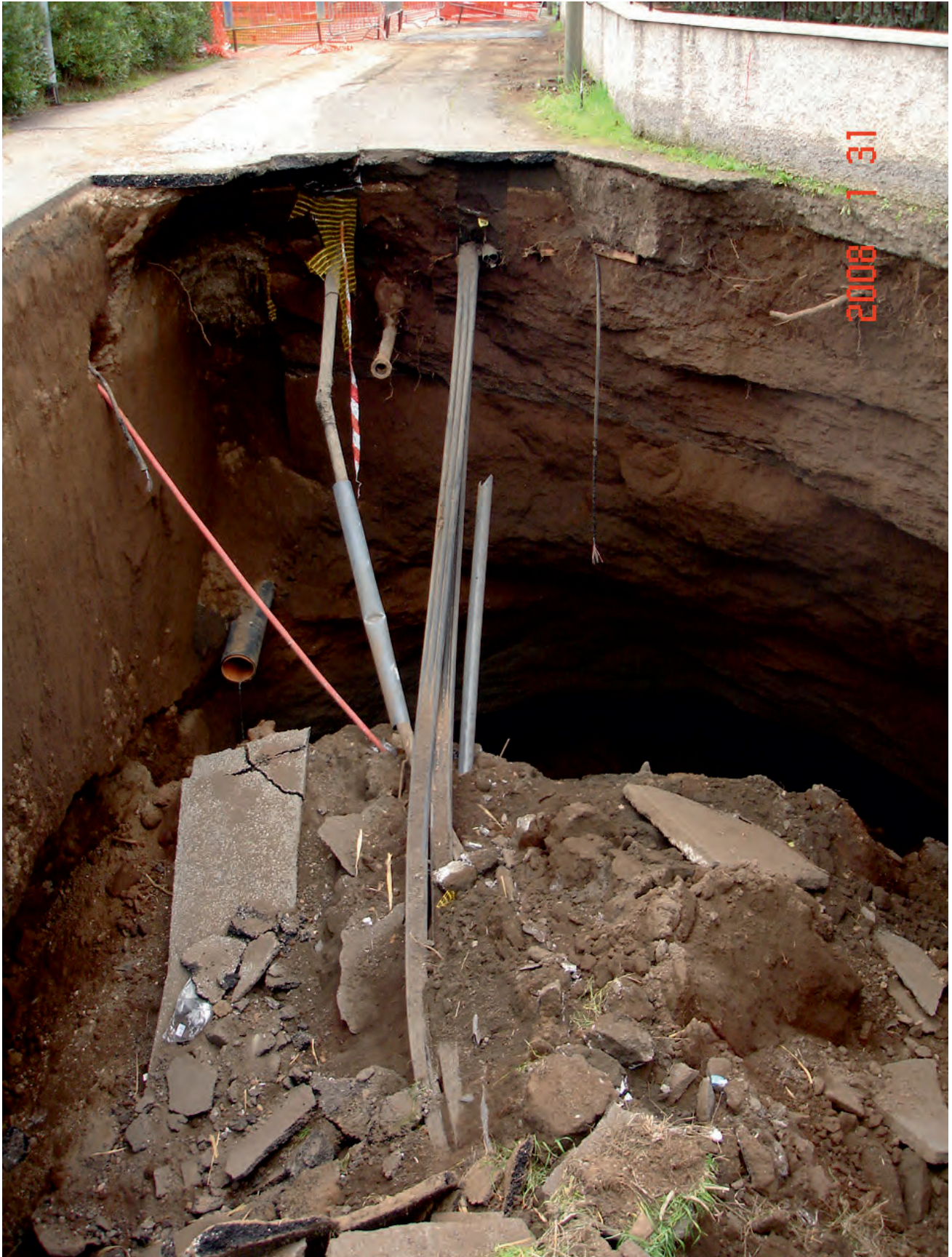
Fig. 15 – Voragine di via Galatea causata da interventi fognari che hanno propiziato il crollo di volte di cavità sotterranee (Foto: Succhiarelli C.). – Anthropogenic sinkhole at Galatea street caused by loss of the sewer network.
