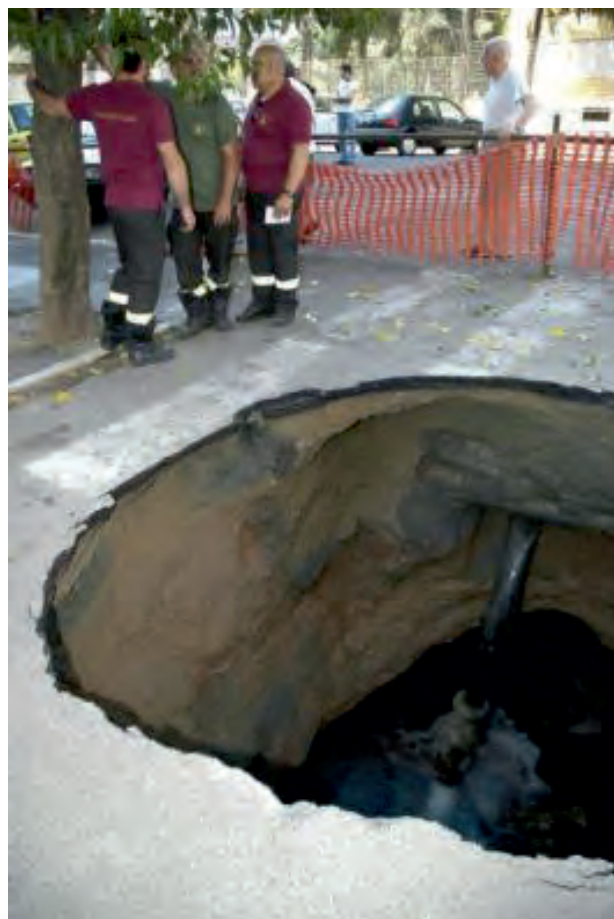
Fig. 21 – Voragine presso Via Gran Paradiso (da www.repubblica.it ). – Anthropogenic sinkhole at Gran Paradiso street, (by website www.Repubblica.it ).
