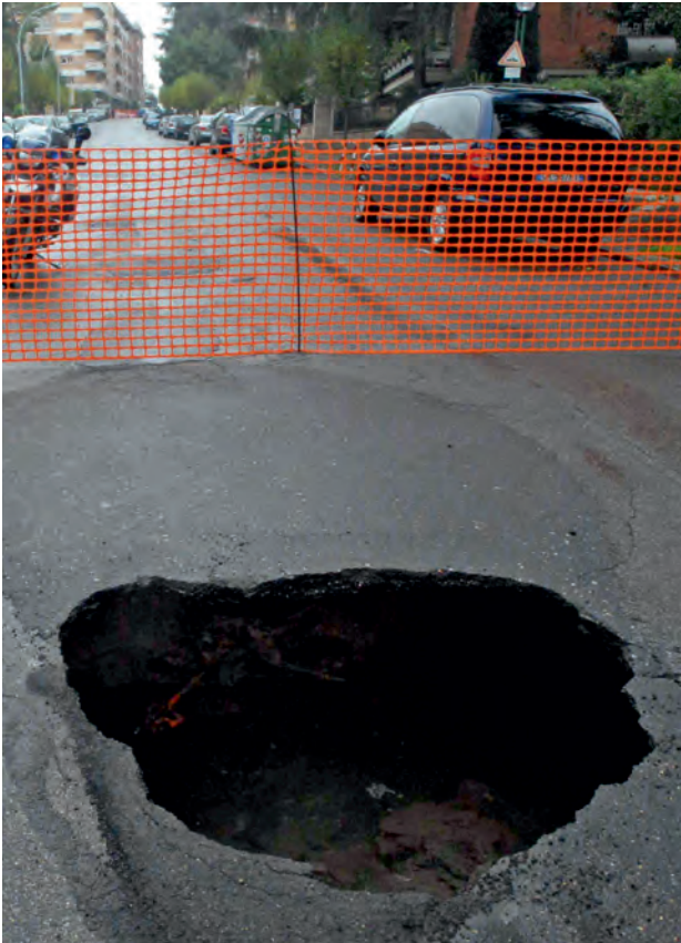
Fig. 14 – Voragine presso il centro urbano di Roma 1 marzo 2007 (foto da www.Repubblica.it ). – Anthropogenic sinkhole in the urban center of Rome, 1th March 2007 (by website www.Repubblica.it )
