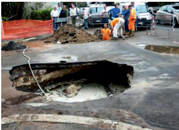
Fig. 22 – Voragine presso via Antonino Bongiorno avvenuta il 23 maggio 2011. – Anthropogenic sinkhole at Antonino Bongiorno street, 23th May 2011.
