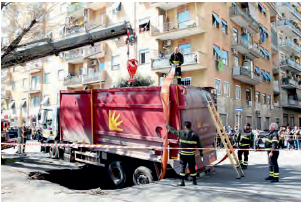
Fig. 17 – Voragine a Roma presso il quartiere di Tor Pignattara, 21 marzo 2009 foto da www.Repubblica.it in cui è stato coinvolto un camion dell'AMA. – Anthropogenic sinkhole in the Tor Pignattara district, 21th March 2009 (by website www.Repubblica.it ).
