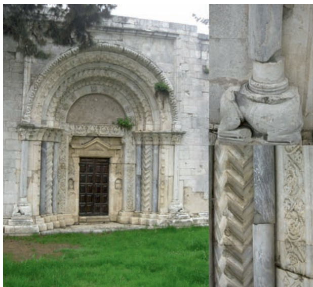
Fig. 5 - Facciata di santa Sabina a San Benedetto dei Marsi e dettagli delle dislocazioni agli elementi architettonici subiti durante il terremoto del 1915. - Facade of Santa Sabina in San Benedetto dei Marsi and details of the dislocations of the building occurred during the earthquake of 1915.
