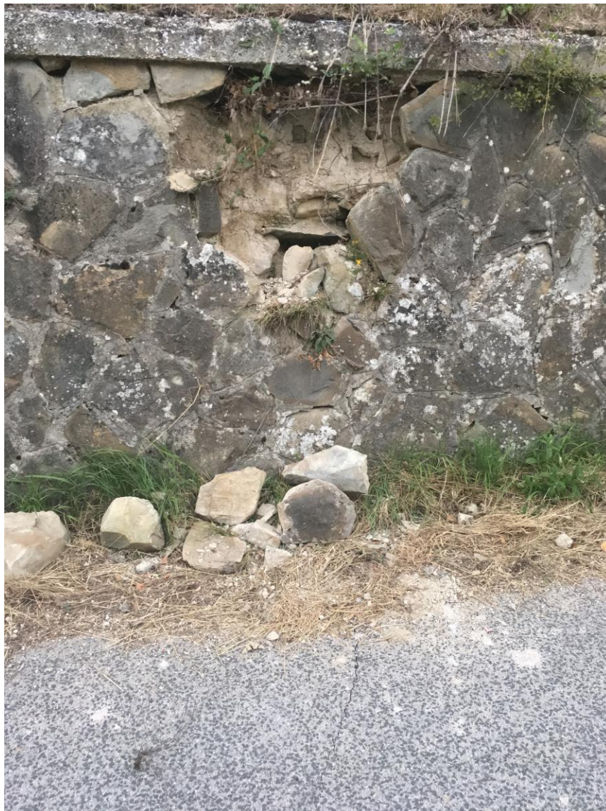
Figura 2 - Fratture minori sul manto stradale e piccolo crollo nei pressi di Cossito.
