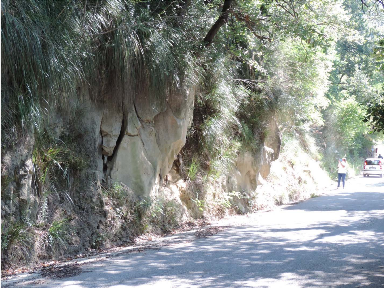
Figura 3. Particolare del tratto di strada oggetto di sopralluogo, località bivio per Cepparano.
