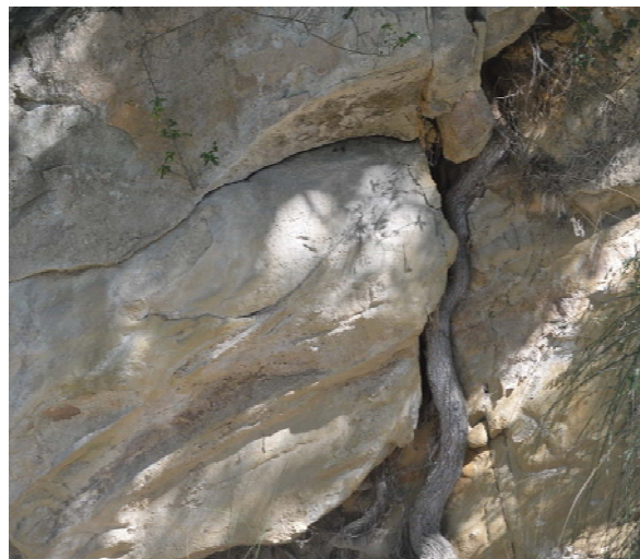
Figura 4. Dettaglio di radici fittonanti causa di detensionamento e apertura delle fratture.
