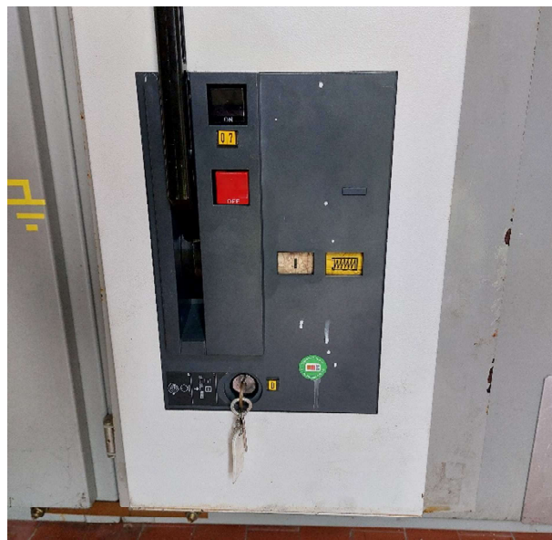
Figura 4: Interruttore MT protezione cabina Laboratori
