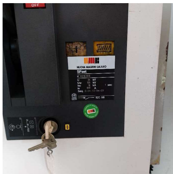
Figura 6: Interruttore MT protezione cabina sede
