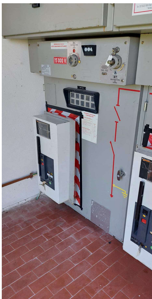
Figura 5: Partenza cabina MT/BT Sede
