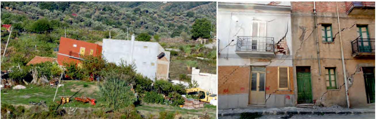
Fig. 526 – Effetti del movimento franoso nei dintorni e all’interno dell’abitato di San Fratello. - Effects of the landslide in the surroundings of and within the San Fratello village.
