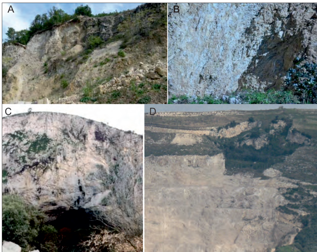
Fig. 19 - Calcari intensamente fratturati all'interno dei sinkhole di M. Pruno a Contursi (A), di Buccino in località Valle di Raio (B), di Castel Morrone (C) e di Canello (D).
