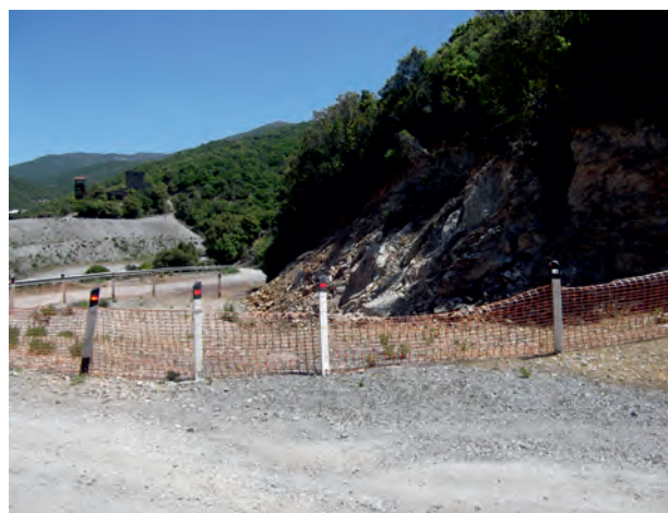
Fig. 6 – Miniera di Montevecchio. Cantiere Casargiu. Nel 2010, nelle vicinanze del pozzo minerario “Fais”, si aprì, lungo la Strada Provinciale n. 66, una grossa voragine di forma sub ellittica profonda circa 10 metri, innescata dal crollo della volta di sottostanti vuoti minerari (circa 15 metri dal p.c. - galleria Fais). Altre profonde voragini (N. 2), anch’esse conseguenti del crollo dei vuoti di coltivazione sottostanti, si sono rilevate lungo il versante sotto la strada dissestata.
