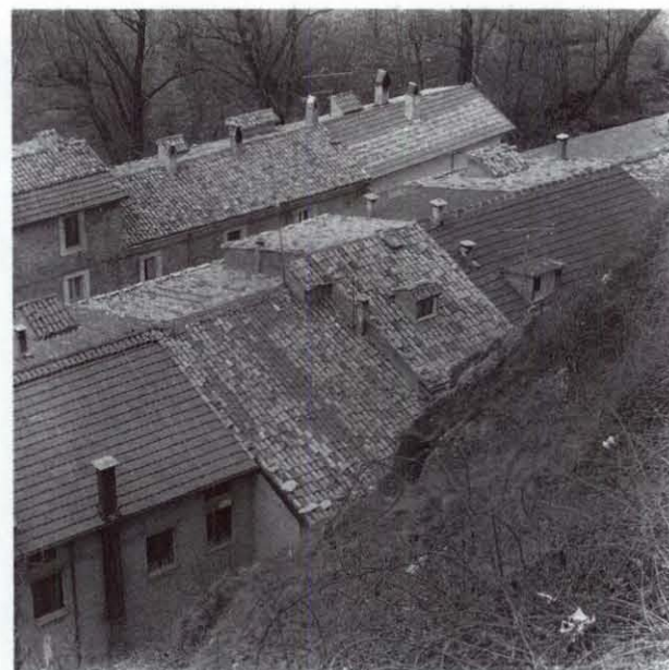
Fig. 62. – Abitato di Villetta Barrea in provincia di l'Aquila. Blocchi di roccia (dolomie prevalenti), anche di grosse dimensioni, sono spesso precipitati sui sottostanti fabbricati (fotografia dell'autore, 1987).
