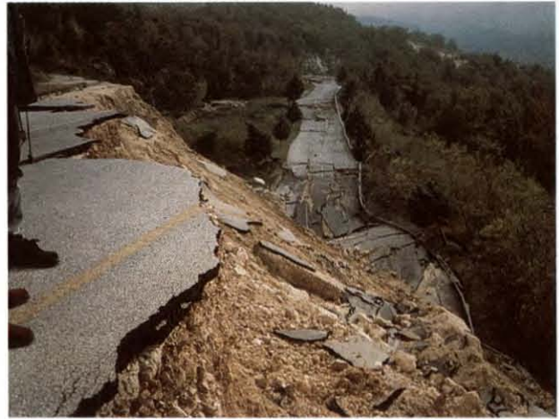
Fig. 63. – Frana di Caramanico Terme in provincia di Pescara, 2-3 luglio 1989. Il franamento ha gravemente coinvolto la strada statale che corre al piede del versante occidentale della Maiella ( fotografia di G. Bigi, Dipartimento Scienze della Terra, Università di Roma ).
