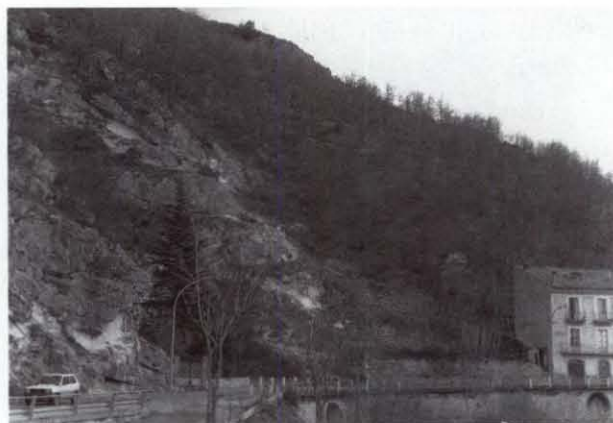
Fig. 61. – Località San Rocco, ai piedi della Montagna del Morrone, territorio comunale di Pacentro in provincia di l'Aquila. Crolli e rotolamenti di rocce determinano pericolo per il transito lungo la strada statale per Caramanico e per alcuni edifici (fotografia dell'autore, 1987).
