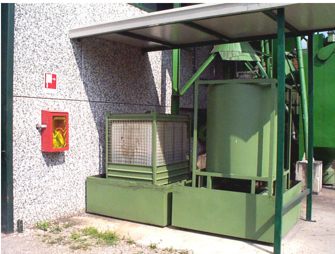
Foto 4.1.1 Stoccaggio esterno di resina e induritore con bacini di contenimento separati.
