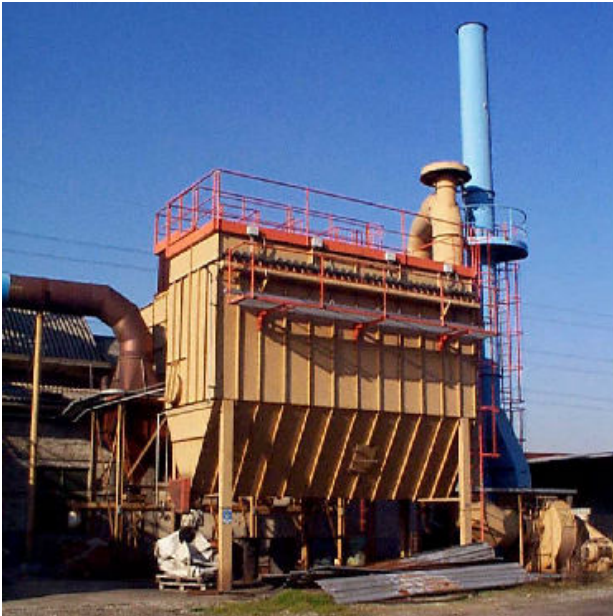
Foto 4.3.1 Impianto abbattimento a secco (maniche) per emissioni provenienti dai forni fusori.
