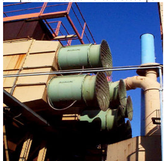
Foto 4.3.1 Particolare dei ventilatori per il raffreddamento dei fumi delle emissioni dai forni
