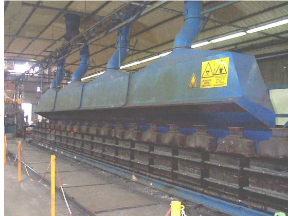
Foto 4.4.1 impianto di aspirazione su linea di colata in forme realizzate con impianto di formatura automatica a verde.
