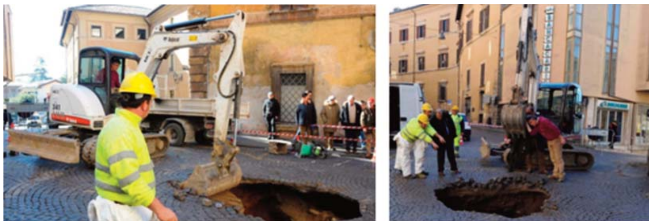
Fig. 16 - Immagini degli eventi di Via Cintia anno 2019; Rottura di una tubatura e innesco di una voragine (da Rieti Life). - Images of the events of Cintia street in the year 2019; Breaking a pipe and triggering of a large sinkhole (from Rieti Life).
