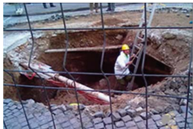
Fig. 15 -Via Cintia: una grande voragine si aprì in strada nel 2011. - Cintia Street: a large sinkhole occurred in the street, in the 2011.
