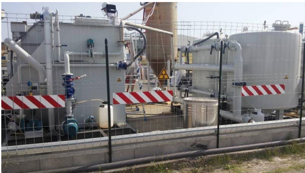
Figura 59. L'impianto di trattamento in loco delle acque provenienti dai pozzi di drenaggio dell'impianto ITREC
