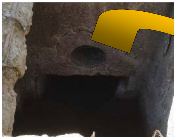
Figura 65. Il pozzetto di raccolta dei reflui non trattati, in evidenza il collegamento con il pozzetto finale di scarico a mare
