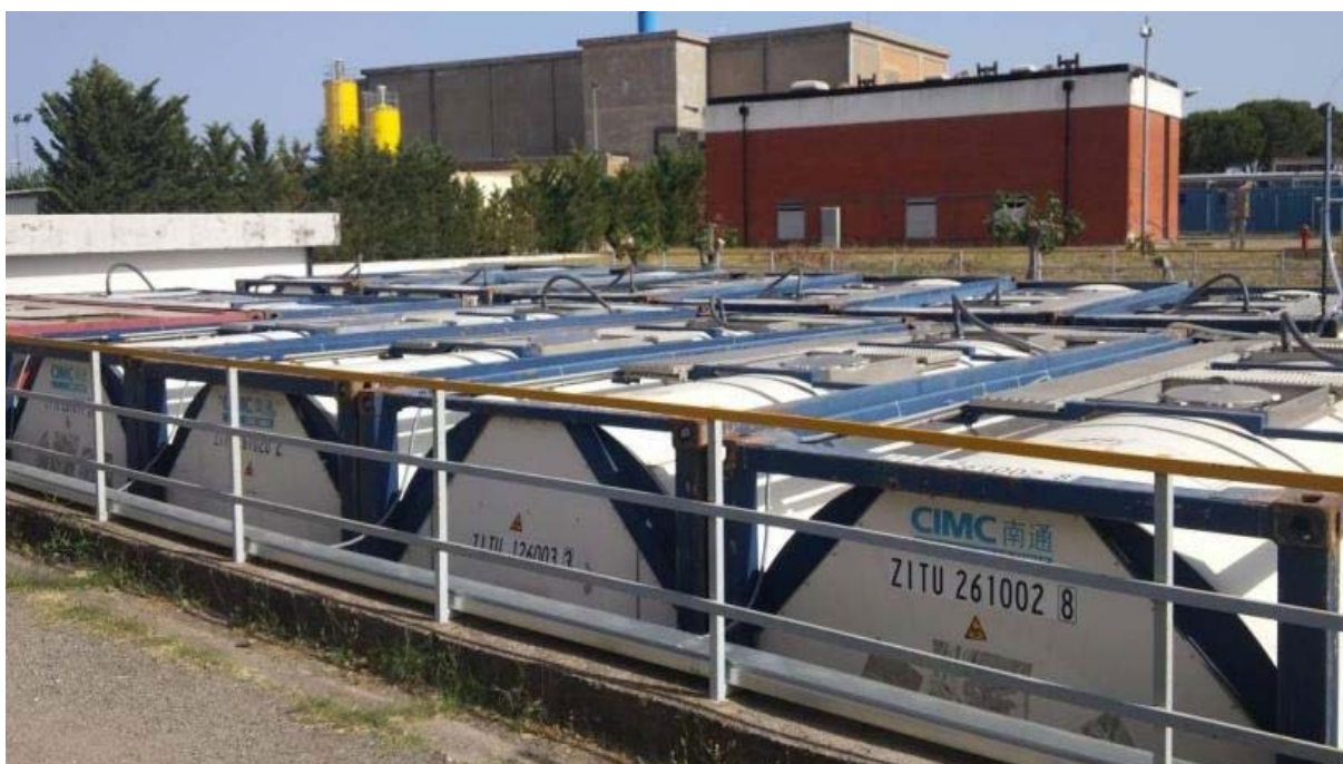
Figura 60. I serbatoi di accumulo in testa all'impianto di trattamento delle acque di falda emunte dai pozzi dell'impianto ITREC.
