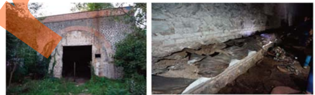
Fig. 14 - Imbocco della galleria di Mussolini (a sinistra) che poi fu utilizzata abusivamente dalla popolazione come discarica o fungaia (a destra). - Entrance to the Mussolini tunnel (left) which was then used illegally by the population as a landfill or for mushroom cultivation (right).
